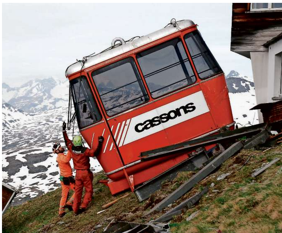
Die demontierte rote Kabine und der Arm sind für den Taltransport bereit.
